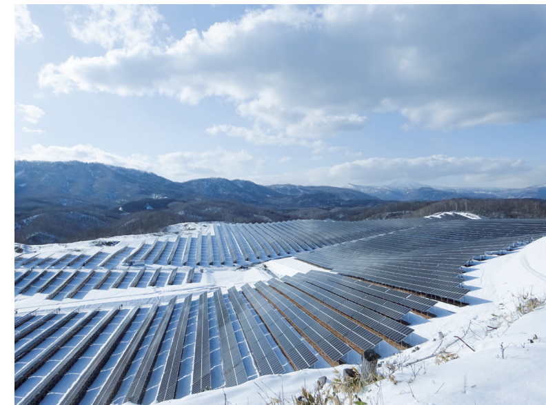
発電所の全景
