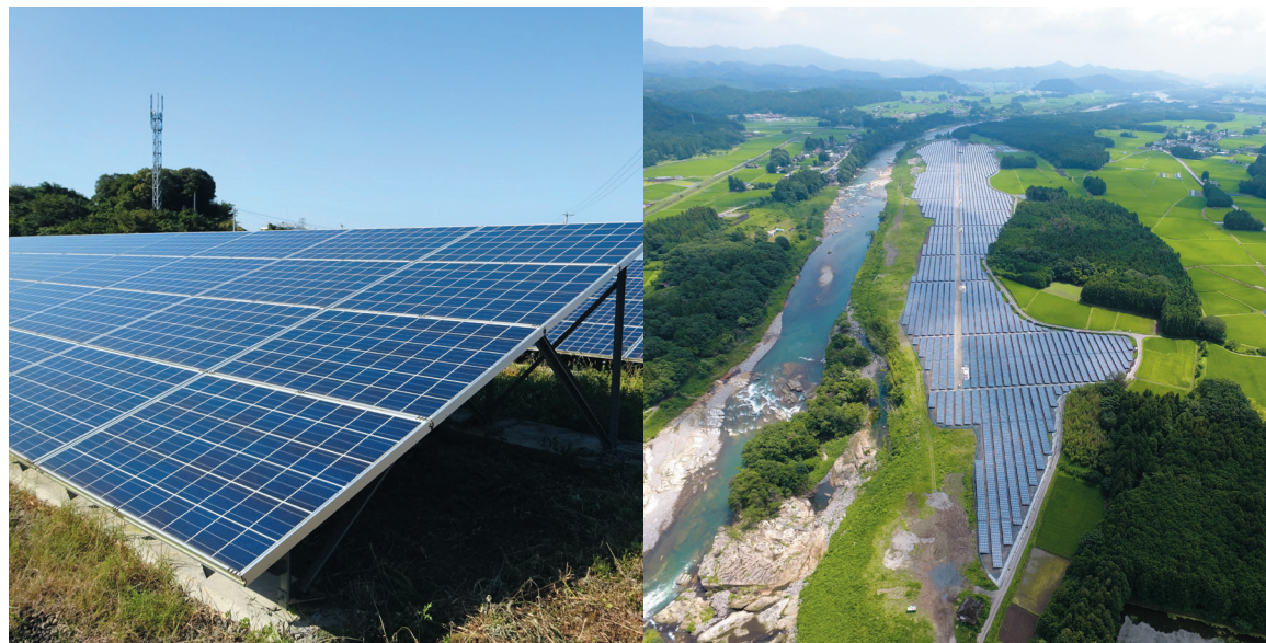
観音寺市(左)と日光市(右)の太陽光発電所
