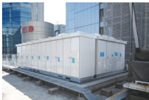
屋上へ移設後の受変電設備 (大阪支店ビル屋上)
